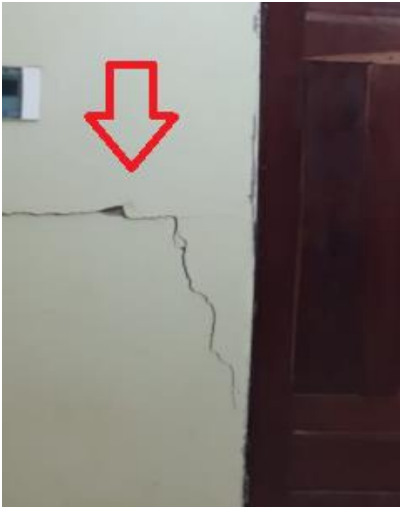
Figura 10. Rachadura com inclinação parcial a 45°, localizada na parede oposta a fachada. Fonte: Autores.
