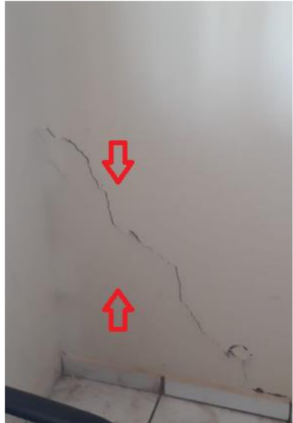
Figura 13. Rachadura a 45° no canto esquerdo da parede de divisória com o deposito. Fonte: Autores.
