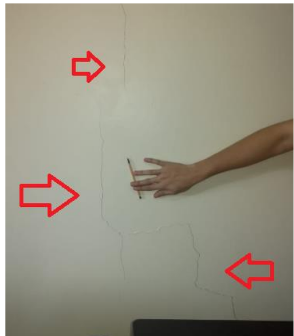
Figura 14. Fissuras na parte central da parede de divisória com o deposito. Fonte: Autores.
