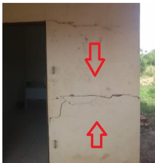
Figura 4. Rachadura horizontal na lateral direita. Fonte: Autores.
