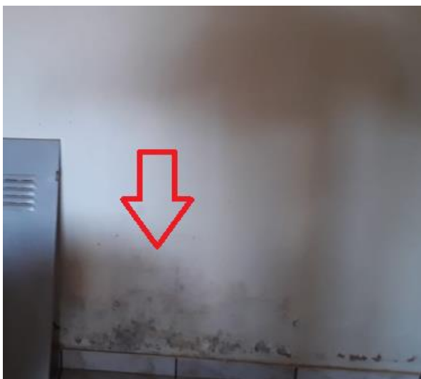
Figura 12. Manchas de infiltração na parede de fundo da sala. Fonte: Autores.
