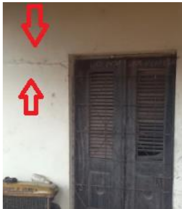
Figura 2. Fissuras no canto superior da porta. Fonte: Autores.
