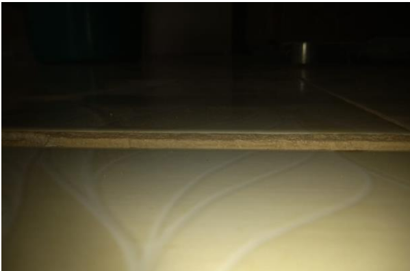
Figura 7. Desnivelamento do piso. Fonte: Autores.
