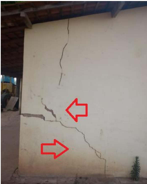
Figura 6. Fenda com inclinação à 45° e destacamento de parte da argamassa. Fonte: Autores.
