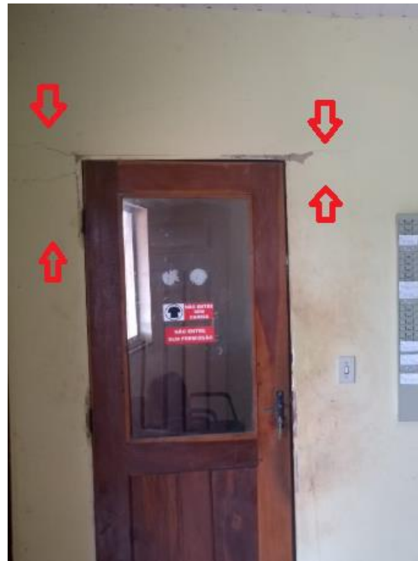
Figura 9. Fissuras localizadas no canto superior da porta de acesso a sala de reunião. Fonte: Autores.
