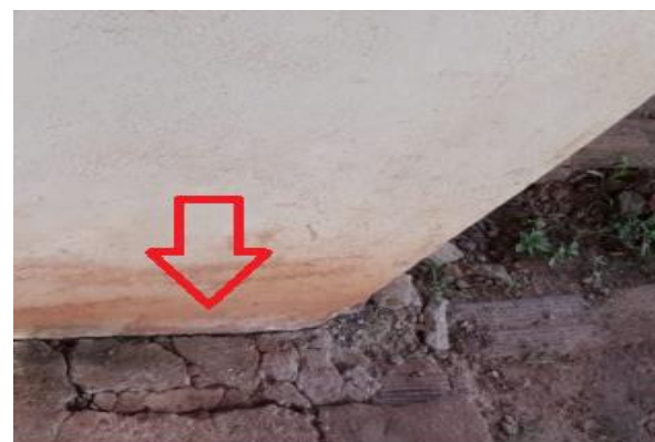
Figura 3. Trinca no piso da área externa. Fonte: Autores.
