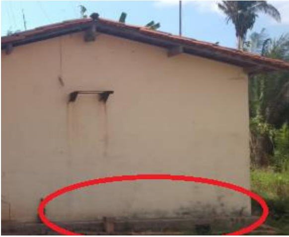
Figura 5. Mancha de infiltração na área inferior da parede. Fonte: Autores.
