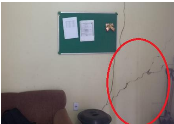
Figura 11. Rachadura na parede oposta a face exterior direita. Fonte: Autores.
