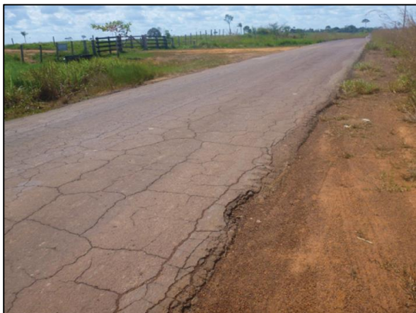
Figura 8. Trinca interligada – tipo bloco. Fonte: CNT (2017) 6 .
