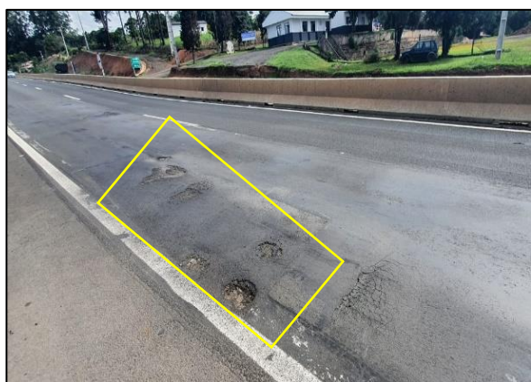
Figura 26. Remendo deteriorado. Fonte: Autores (2022).
