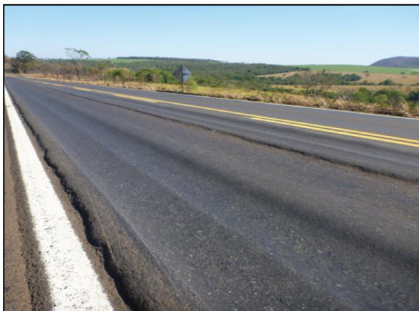
Figura 9. Afundamento plástico. Fonte: CNT (2017) 6 .
