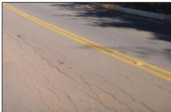
Figura 6. Trinca longitudinal. Fonte: CNT (2017) 6 .
