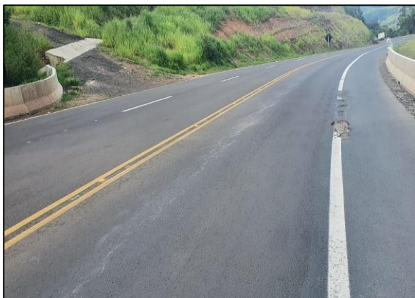
Figura 21. Trinca interligada – tipo jacaré, na fase inicial. Fonte: Autores (2022).
