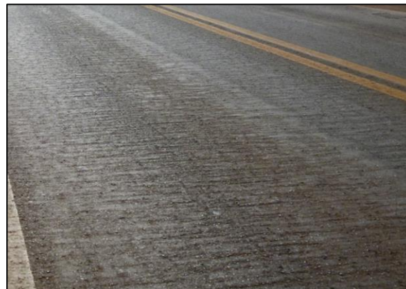
Figura 11. Ondulação ou Corrugação. Fonte: CNT (2017) 6 .
