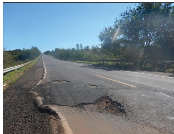
Figura 12. Escorregamento. Fonte: CNT (2017) 6 .
