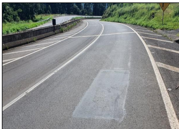
Figura 25. Remendo. Fonte: Autores (2022).
