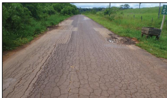
Figura 7. Trinca interligada – tipo jacaré. Fonte: CNT (2017) 6 .
