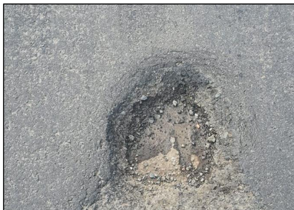
Figura 24. Painela ou buraco. Fonte: Autores (2022).
