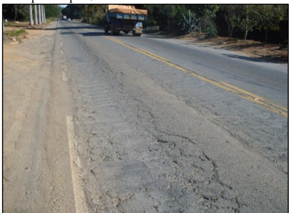
Figura 10. Afundamento de consolidação. Fonte: CNT (2017) 6 .
