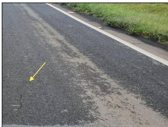
Figura 18. Fissura. Fonte: Autores (2022).
