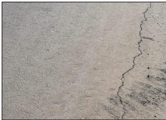
Figura 20. Trinca isolada longitudinal. Fonte: Autores (2022).
