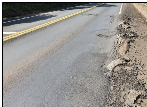
Figura 23. Escorregamento. Fonte: Autores (2022).
