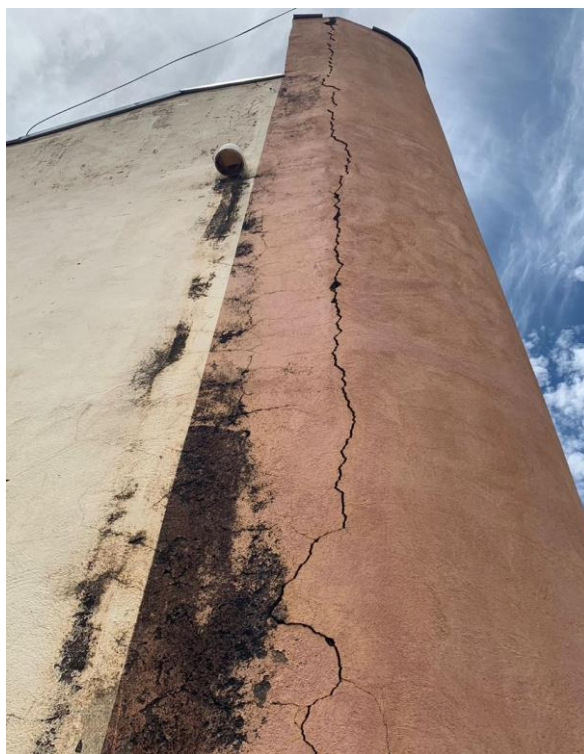
Figura 7. Pontos Críticos da Segunda Inspeção, aberturas no elemento. Fonte: Elaborado pelo autor (2023)
