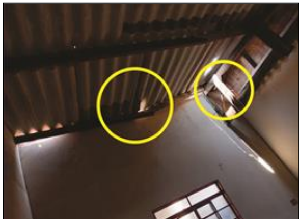
Figura 2. Pontos Críticos da Primeira Inspeção, estruturas de madeira escassas na cobertura. Fonte: Elaborado pelo autor (2023)
