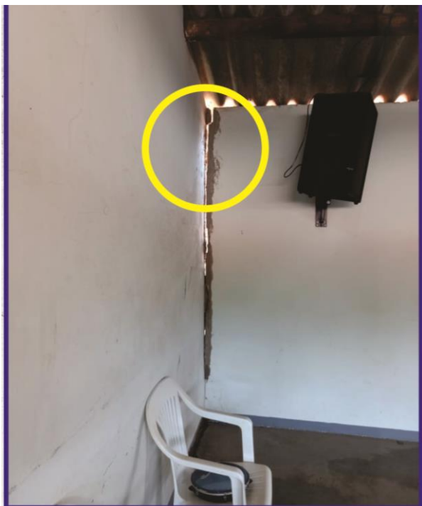
Figura 3. Pontos Críticos da Primeira Inspeção, aberturas na junção entre paredes. Fonte: Elaborado pelo autor (2023)
