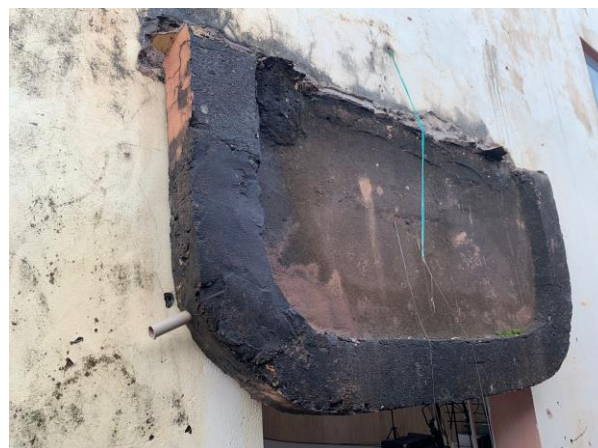
Figura 4. Pontos Críticos da Segunda Inspeção, queda de marquise. Fonte: Elaborado pelo autor (2023)
