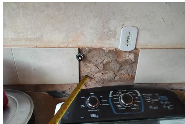
Figura 37. Destacamento do revestimento. Fonte: Os autores (2023).
