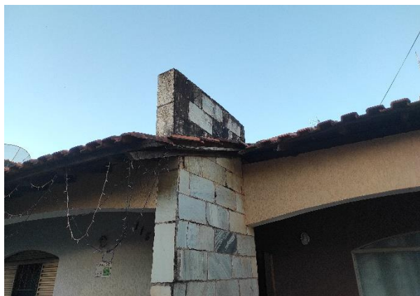
Figura 23. Mancha de umidade. Fonte: Os autores (2023).
