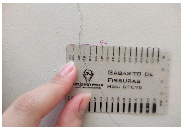
Figura 44. Medição da fissura externa P3. Fonte: Os autores (2023).
