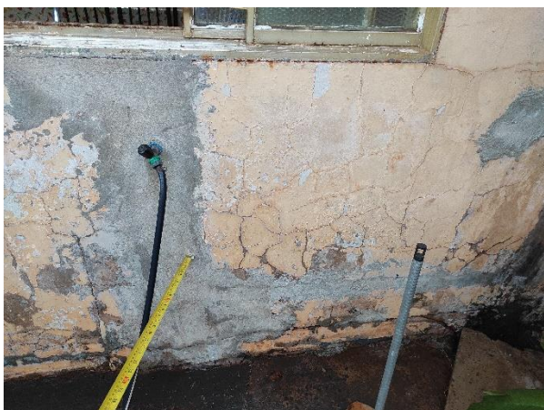
Figura 35. Marcas de reparo, manchas de umidade e fissura do tipo mapeamento. Fonte: Os autores (2023).
