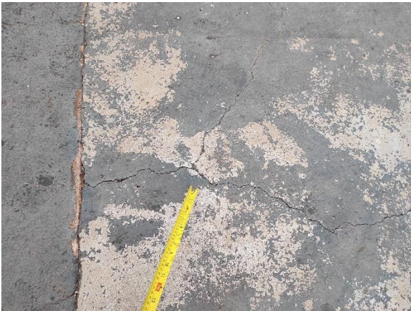
Figura 39. Trinca do tipo mapeamento e deterioração da pintura. Fonte: Os autores (2023).
