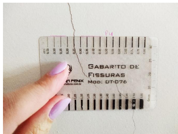
Figura 47. Medição da fissura interna P4. Fonte: Os autores (2023).
