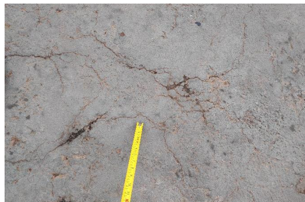
Figura 26. Fissuras do tipo mapeamento. Fonte: Os autores (2023).
