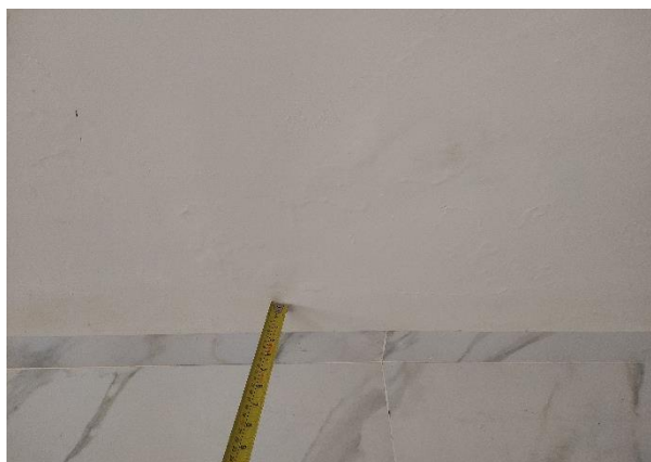
Figura 12. Vesícula de umidade e fissura do tipo mapeamento. Fonte: Os autores (2023).
