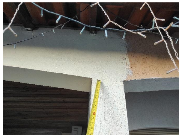
Figura 36. Marca de reparo. Fonte: Os autores (2023).
