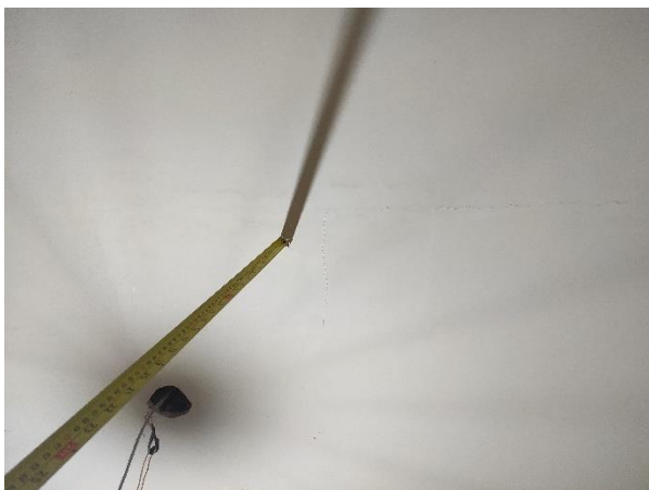
Figura 27. Fissura do tipo mapeamento. Fonte: Os autores (2023).
