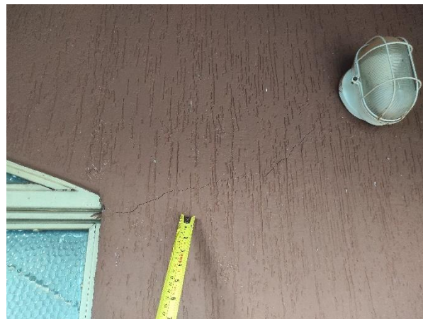
Figura 30. Fissura diagonal. Fonte: Os autores (2023).
