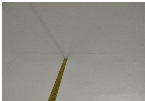
Figura 32. Fissura. Fonte: Os autores (2023).
