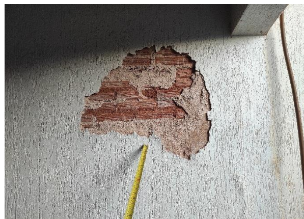
Figura 20. Destacamento de pintura. Fonte: Os autores (2023).
