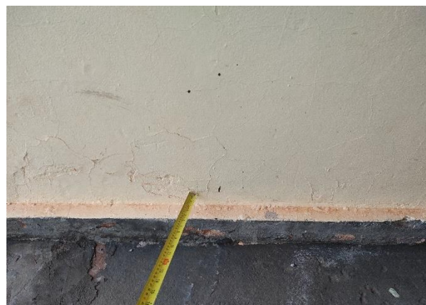
Figura 25. Fissura do tipo mapeamento. Fonte: Os autores (2023).
