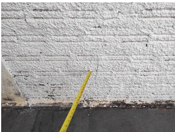
Figura 28. Fissura vertical. Fonte: Os autores (2023).
