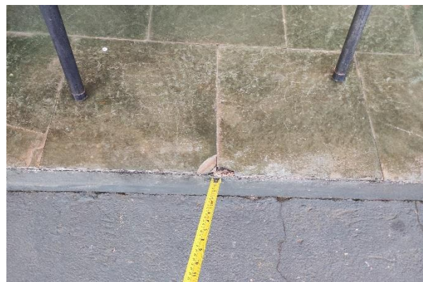
Figura 38. Deterioração. Fonte: Os autores (2023).
