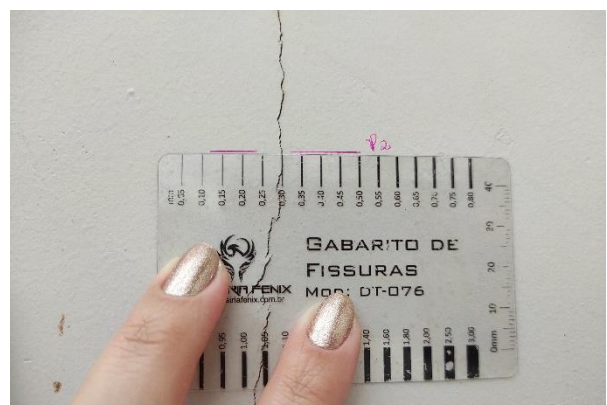
Figura 43. Medição da fissura interna P2. Fonte: Os autores (2023).
