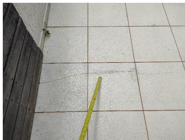
Figura 9. Fissura. Fonte: Os autores (2023).
