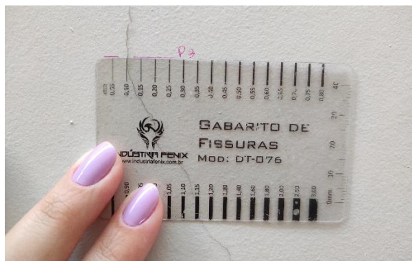
Figura 45. Medição da fissura externa P3. Fonte: Os autores (2023).
