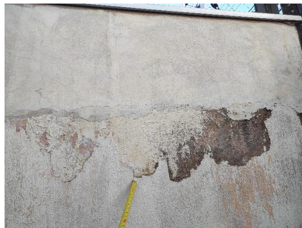
Figura 19. Destacamento de pintura e mancha de umidade. Fonte: Os autores (2023).
