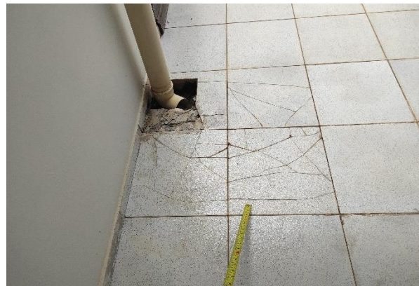
Figura 13. Trincas do tipo mapeamento. Fonte: Os autores (2023).
