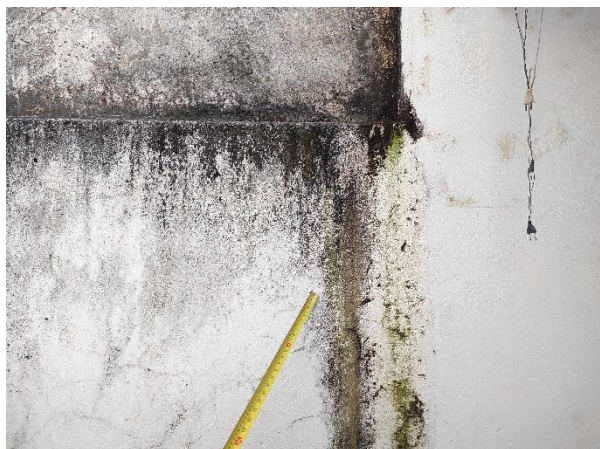
Figura 21. Mancha de umidade. Fonte: Os autores (2023).
