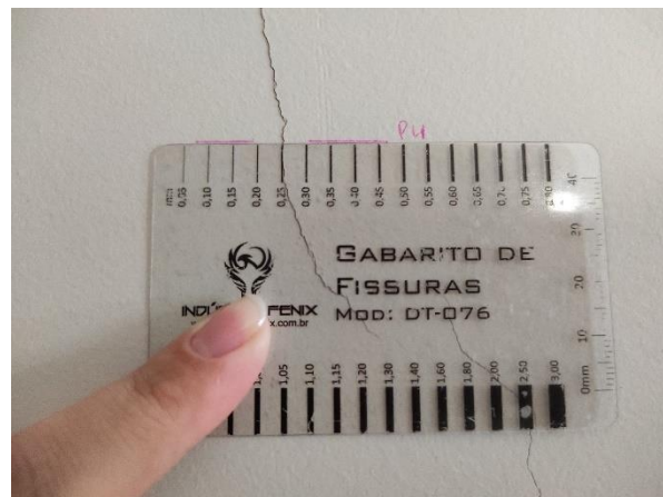
Figura 46. Medição da fissura interna P4. Fonte: Os autores (2023).
