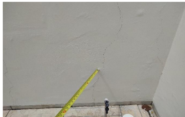
Figura 7. Fissura vertical e vesículas de umidade. Fonte: Os autores (2023).
