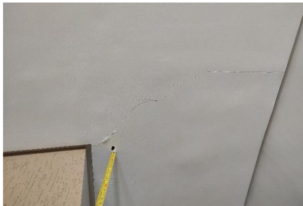
Figura 10. Fissura e deterioração. Fonte: Os autores (2023).
