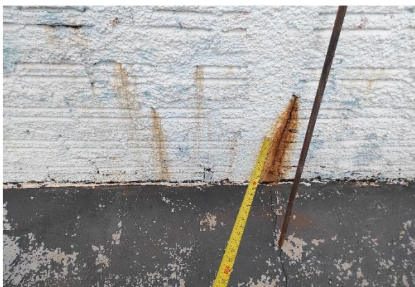
Figura 33. Corrosão da armadura. Fonte: Os autores (2023).
