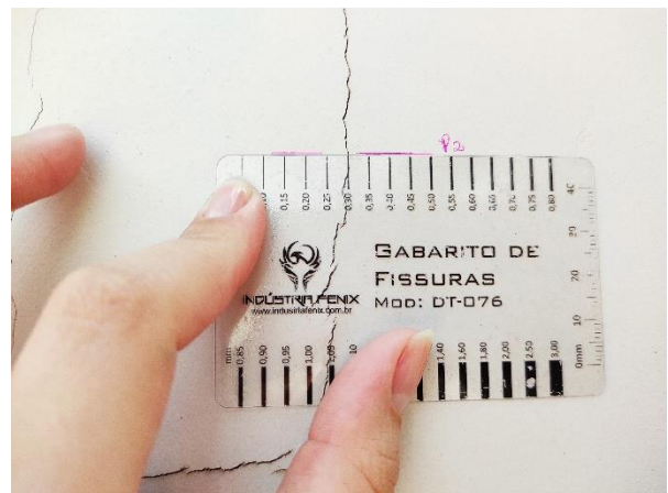
Figura 42. Medição da fissura interna P2. Fonte: Os autores (2023).
