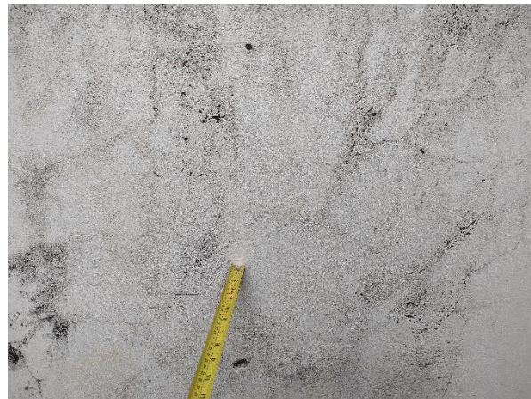
Figura 24. Fissura do tipo mapeamento e mancha de umidade. Fonte: Os autores (2023).
