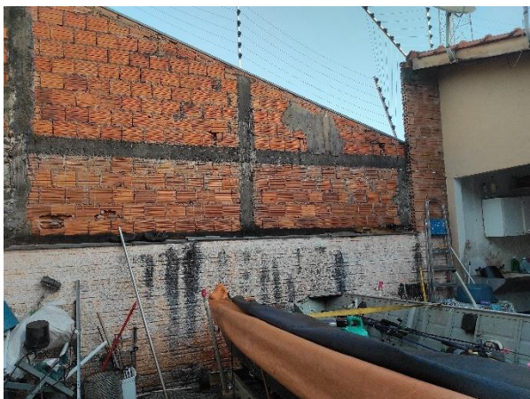
Figura 34. Ausência de acabamento e manchas de umidade. Fonte: Os autores (2023).
