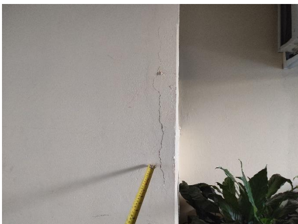
Figura 29. Trinca vertical. Fonte: Os autores (2023).
