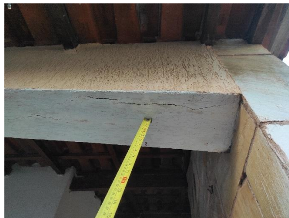
Figura 31. Trinca. Fonte: Os autores (2023).
