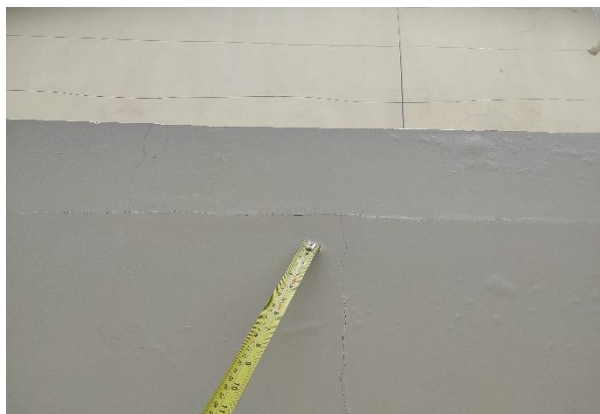
Figura 11. Fissura do tipo mapeamento. Fonte: Os autores (2023).
