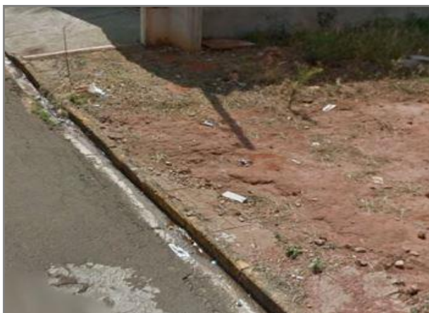
Figura 5. Trecho com ausência de revestimento no calçamento. Fonte: Elaborado pelos autores
