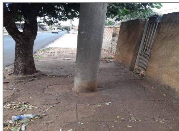
Figura 4. Trecho com limitação da faixa de circulação devido à instalação de poste do centro da calçada. Fonte: Elaborado pelos autores.
