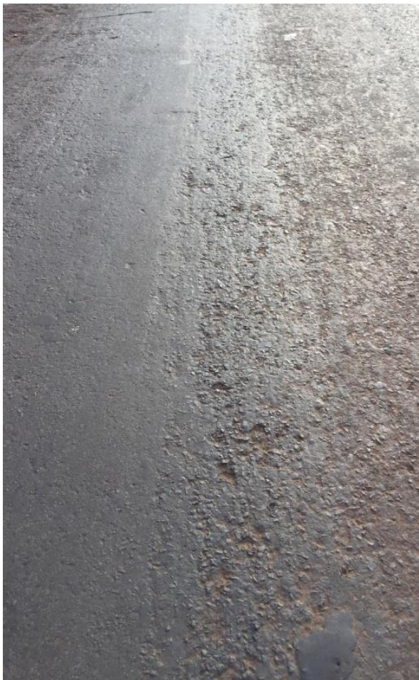
Figura 4: Exsudação na Av. Valério Osmar Estevão, Ângulo – PR. Fonte: Elaborado pelo Autor (2019)
