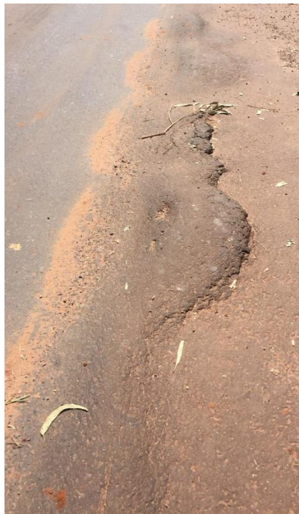
Figura 3: Escorregamento na Av. Valério Osmar Estevão, Ângulo – PR. Fonte: Elaborado pelos autores (2019)
