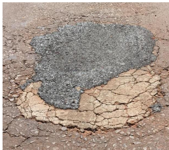
Figura 8: Remendo na Av. Valério Osmar Estevão, Ângulo – Pr. Fonte: Elaborado pelo Autor (2019).
