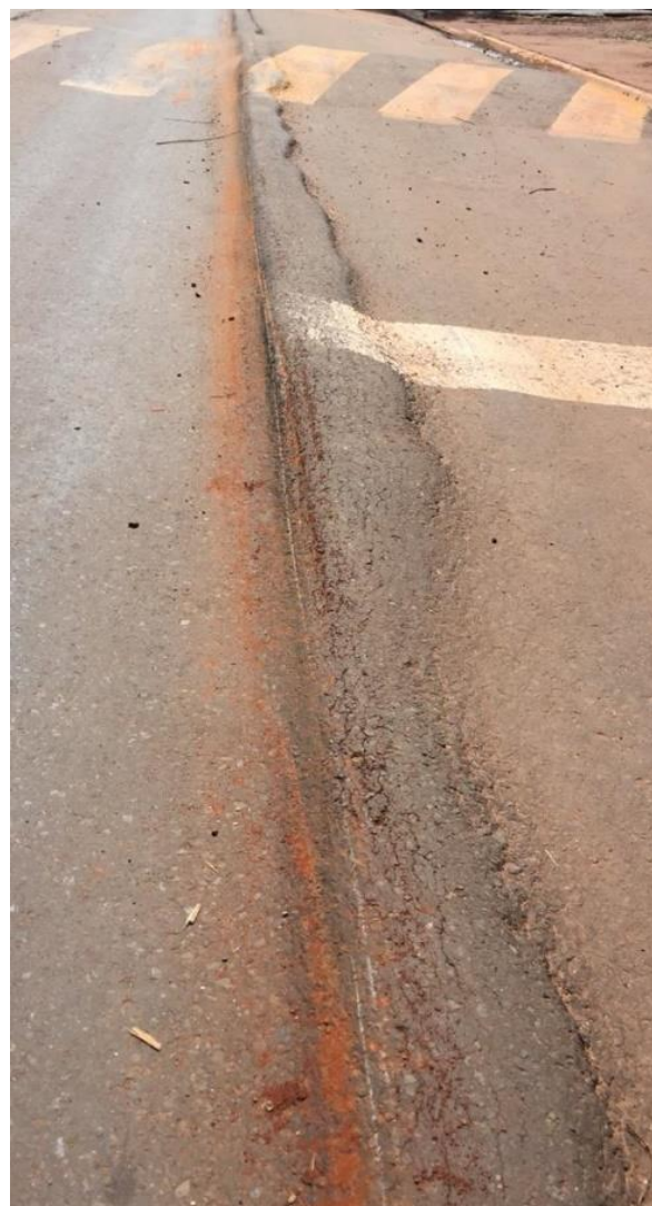
Figura 1: Patologia de Afundamento causado na Av. Valério Osmar Estevão, Ângulo – PR. Fonte: Elaborado pelo autor (2019)
