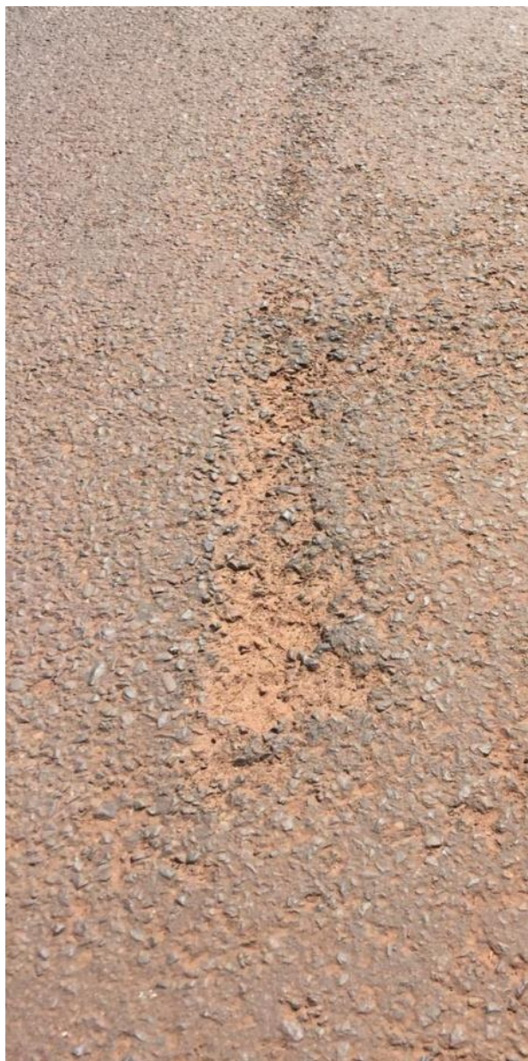
Figura 2: Desgaste na Av. Valério Osmar Estevão, Ângulo – PR. Fonte: Elaborado pelo Autor (2019)
