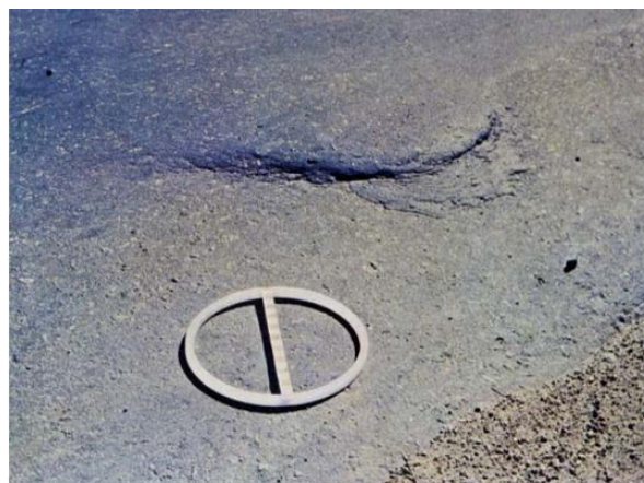
Figura 10. Escorregamento. Fonte: DNIT 005/2003 – TER (2003) 7 .
