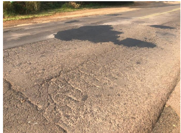
Figura 18. Trincas interligadas do tipo couro de jacaré. Fonte: os autores (2022).
