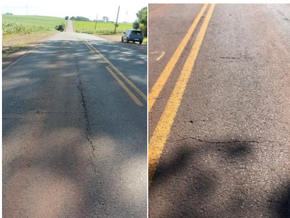
Figura 19. Trincas isoladas do tipo longitudinal longa e transversal curta, respectivamente. Fonte: os autores (2022).
