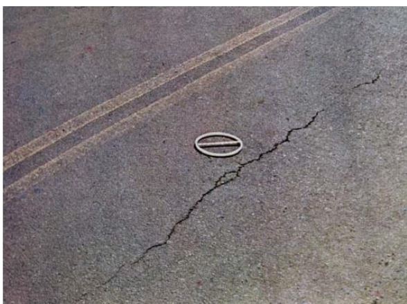
Figura 5. Trinca isolada. Fonte: DNIT 005/2003 – TER (2003) 7 .
