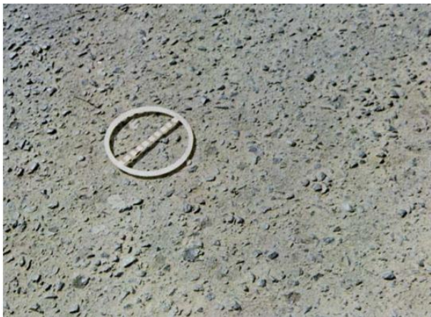
Figura 8. Desgaste do pavimento. Fonte: DNIT 005/2003 – TER (2003) 7 .
