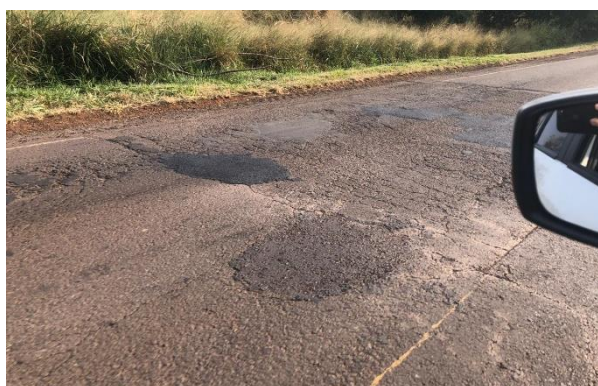
Figura 15. Remendo superficial. Fonte: os autores (2022).
