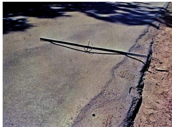
Figura 7. Afundamento da trilha de roda. Fonte: DNIT 005/2003 – TER (2003) 10 .
