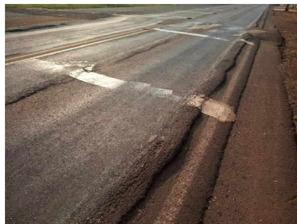
Figura 16. Escorregamento do revestimento nos bordos. Fonte: os autores (2022).
