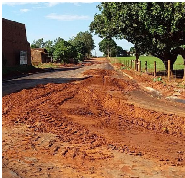
Figura 5: Troca de solo com patologia. Fonte: Autor (2021).
