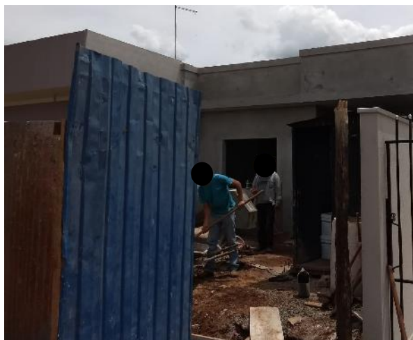
Figura 2. Obra visitada que está localizada no bairro Jardim Progresso em Mandaguari. Fonte: Autores (2018).
