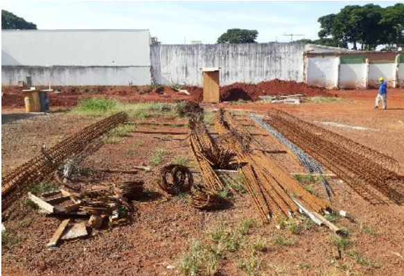
Figura 9. Armazenagem de bitolas de aço. Fonte: os Autores (2019).
