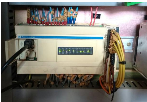
Figura 1 – CLP instalado em painel de comando. Fonte: O autor (2018).
