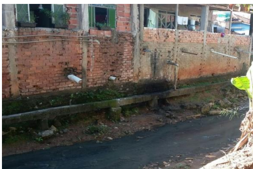
Figura 1. Esgoto sem tratamento sendo despejado diretamente das casas. Fonte: Própria
